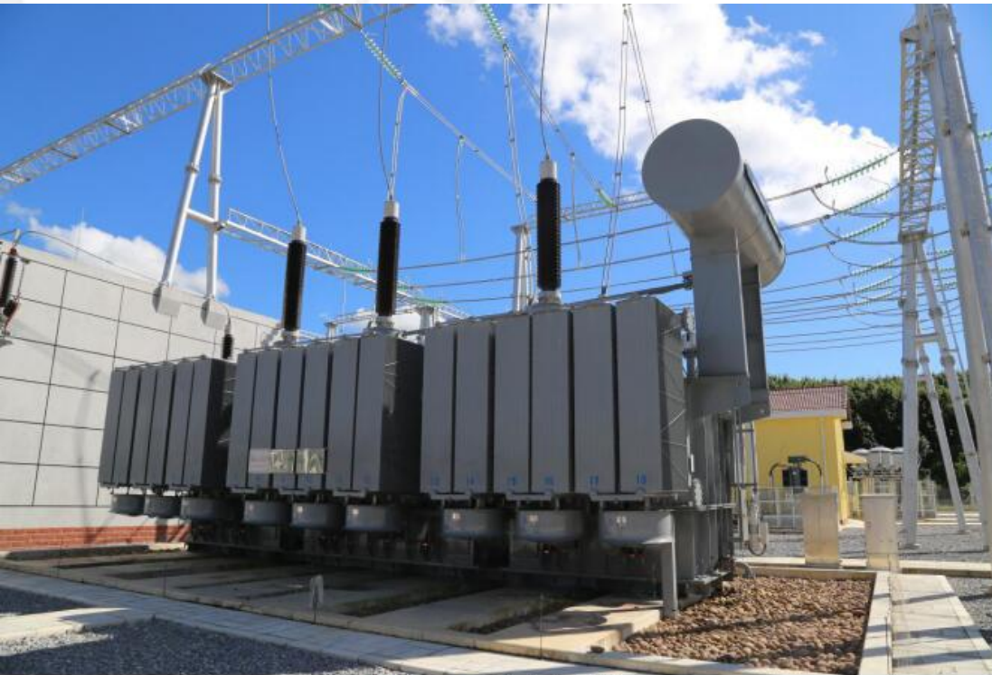
国产 230 千伏主变压器
